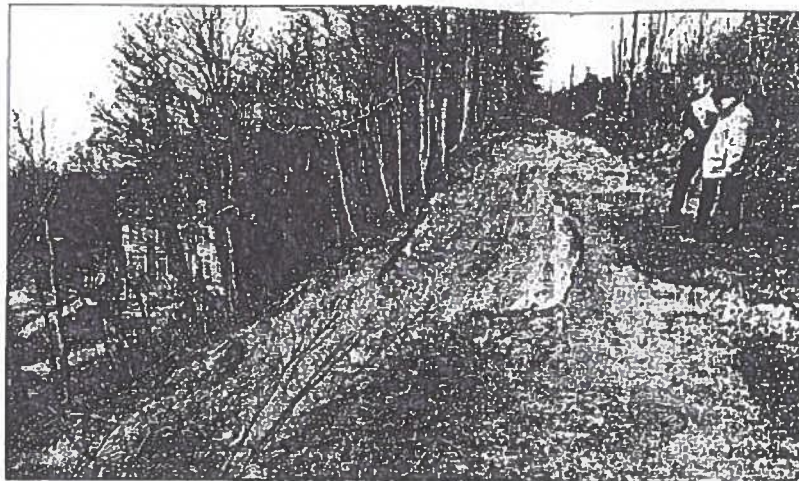
Frédéric Herman, ingénieur géotechnicien et Michel Barillet, le responsable des services techniques, ont observé l'éboulement en détail, mardi.
