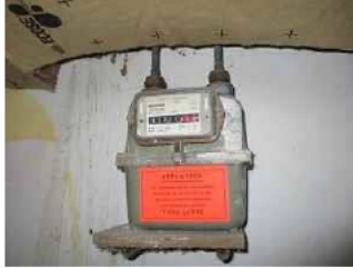
Présence d'un compteur gaz dans la cave
